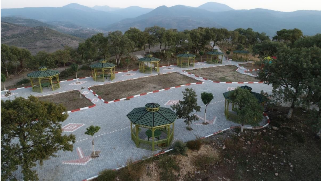
4-) Servi mahallesi Metehan sokak yanı park ve yeşil alan düzenleme çalışmaları devam etmektedir.
